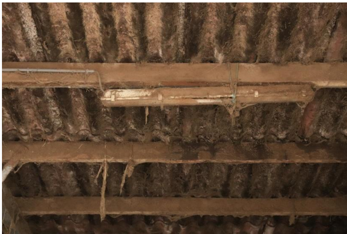
Foto 4: Asbestbeplating en spinnenrag in de stallen
